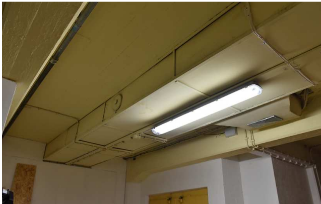
Kuva: Sisäkatoissa on jäljellä vanhoja ilmanvaihtokanavia ja erilaisia loisteputki-valaisimia.
