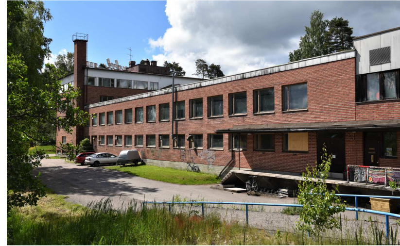
Kuva: 1960-luvulla tehdyn laajennusosan (B) itäsiivu. Vanhan puolen itäpäädyssä on ollut puurunkoinen halkokatos.
